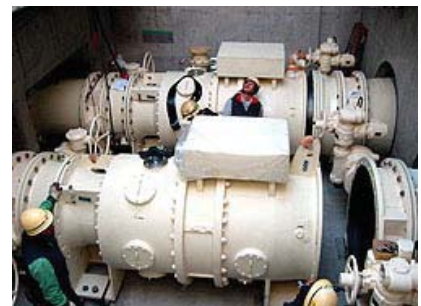
巨大な排水ポンプ
