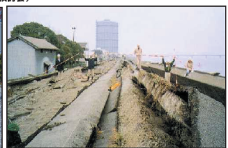
兵庫県南部地震（平成7年）による淀川の堤防の被災状況
