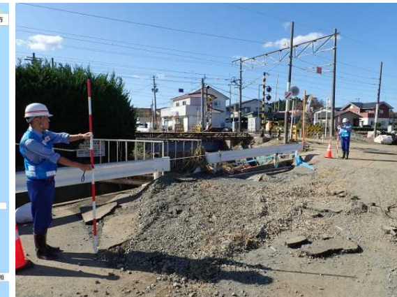
■10/28 道路被災状況調査 (福島県相馬市)
