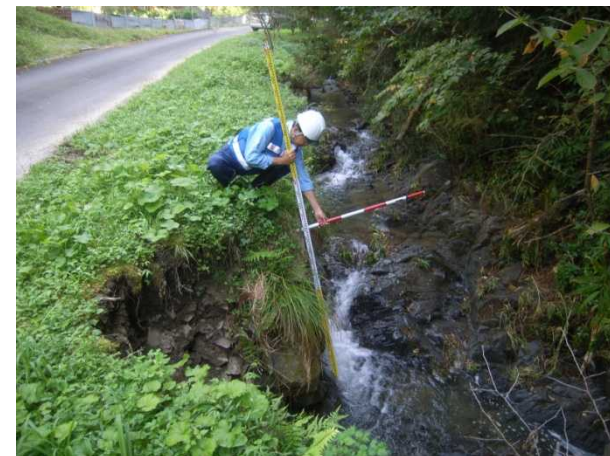
被災状況の調査
