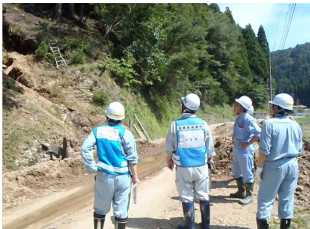
道路法面崩落箇所の調査(今津地区)
