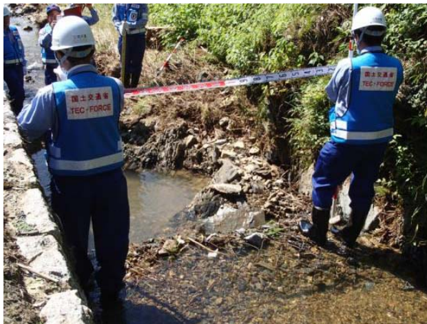
河川被災箇所への調査(東八田地区)
