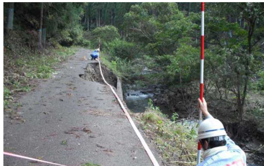
にこだに 仁吾谷地区道路の壊箇所調査
