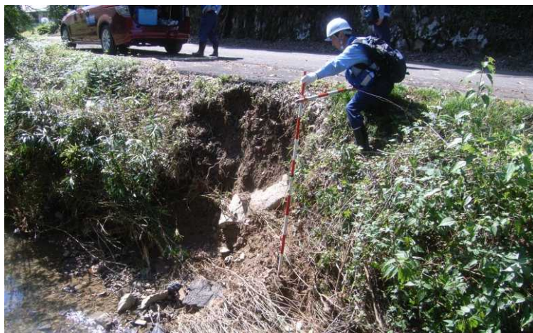
河川被災状況調査(福知山市域他)
