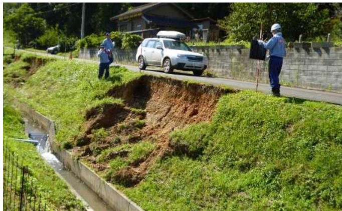
道路法面被災箇所の調査
