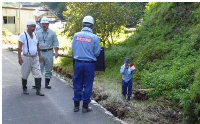
道路法面被災箇所の調査
