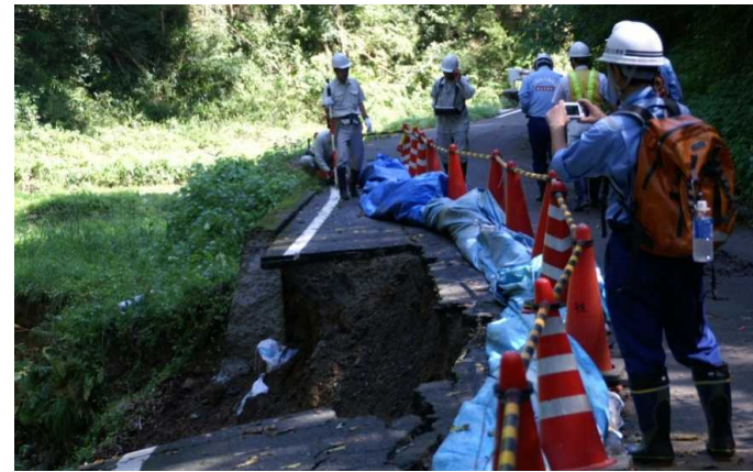
道路の被災状況調査(白滝地区)
