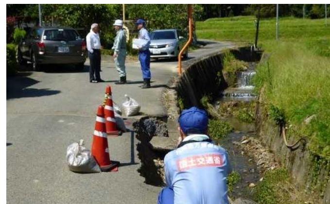
水路護岸の被災箇所の調査
