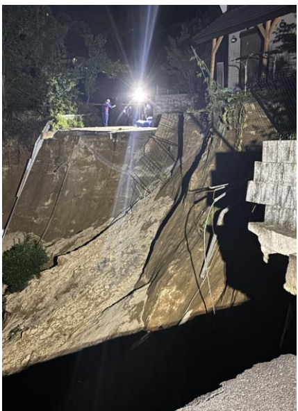
崩落現場の状況
