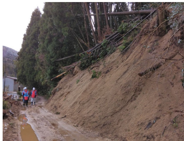
【道路班】輪島市 被災状況調査（22日）
