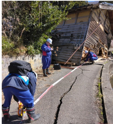
【道路班】輪島市 被災状況調査（13日）
