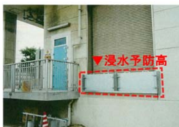
写真 2.1.1 住之江下水処理場の耐水化事例
