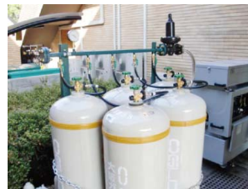
図3 移動式ガス発生設備
