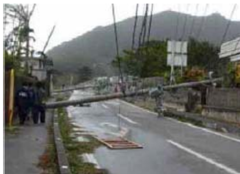
写真 3.2.1 台風による電柱の倒壊
