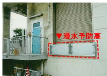
写真 2.1.1 住之江下水処理場の耐水化事例
