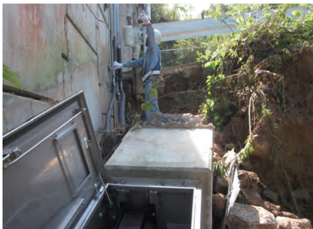
倒壊した分電盤(9月5日)
