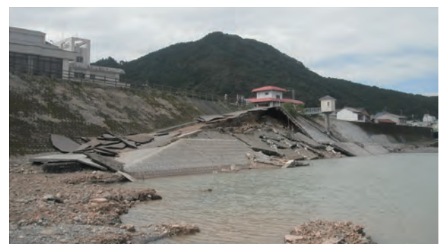
被災状況(9月5日)
