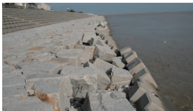
①紀宝町湊地区 護岸損傷(9月5日)
