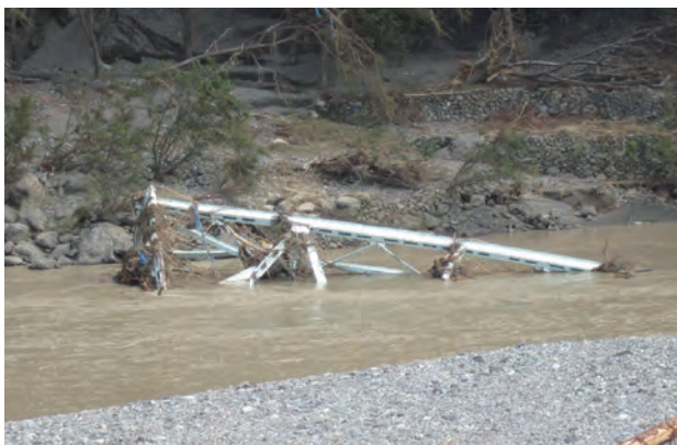
流されたトラス桁
