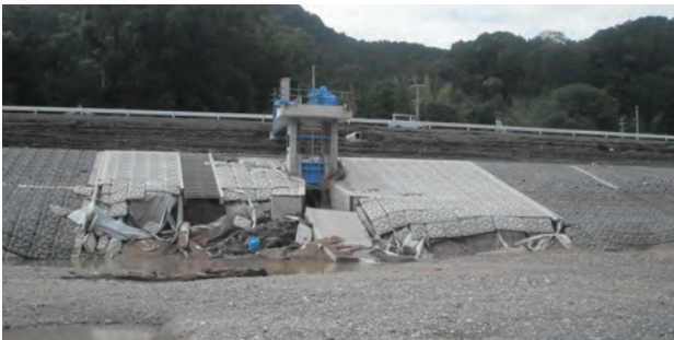
被災状況(9月5日)
