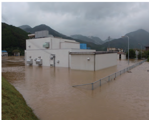
相野谷川排水機場電気室(浸水状況、9月4日11時頃)
