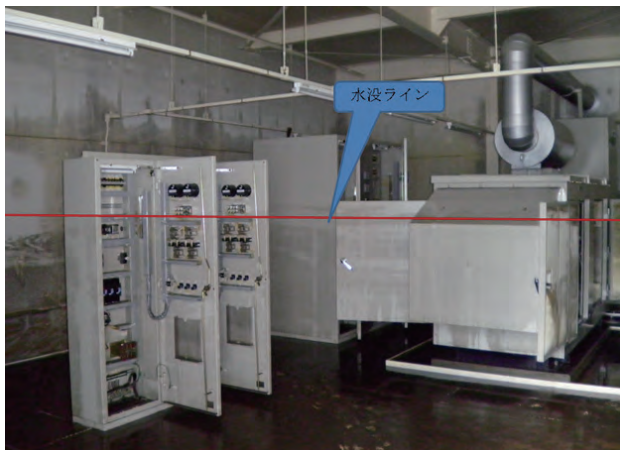
相野谷川排水機場発電機内部
