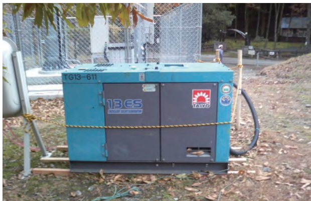
仮設発電機(赤谷)
