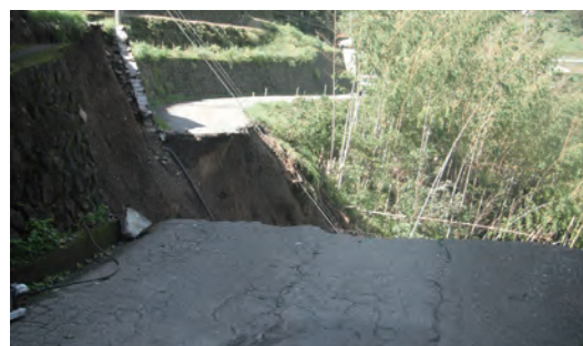
十津川村谷垣内の寸断された道路(9月7日)
