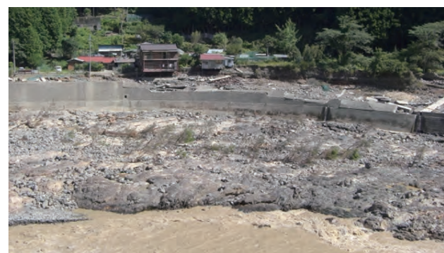
十津川村滝川 護岸被災状況(9月7日)
