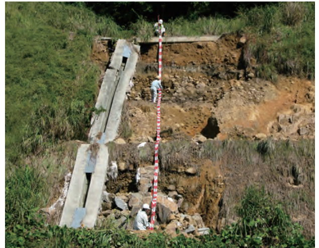
佐野地区の土砂崩れ(9月4日)
