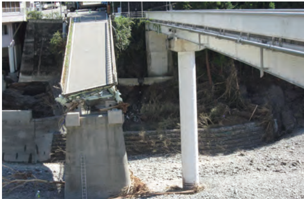
鈹桁(A1-P1)の落橋
