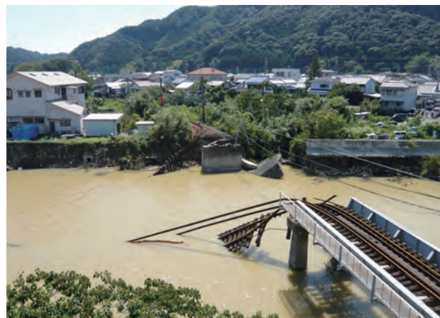
紀勢本線那智川橋梁(落橋)
