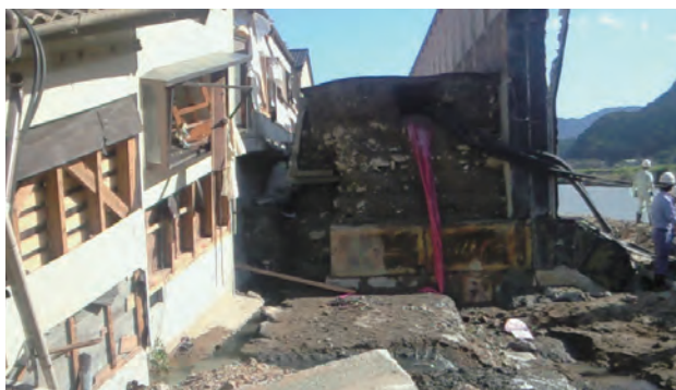
高岡輪中堤の転倒で切断された光ケーブル(9月6日)
