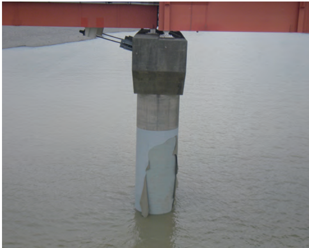
橋脚の塗装剥離(10月4日)
