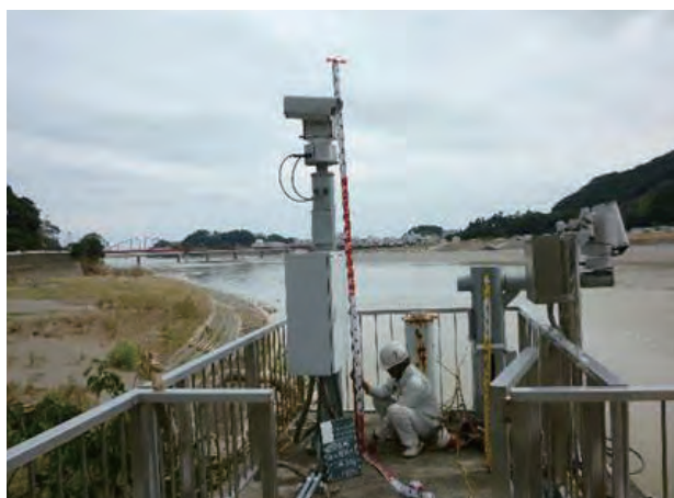
鮎田水門監視カメラ状況
