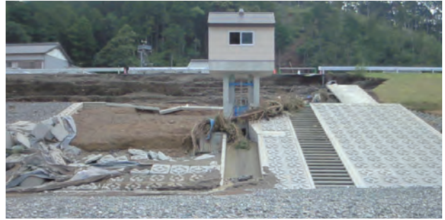
被災状況(9月5日)
