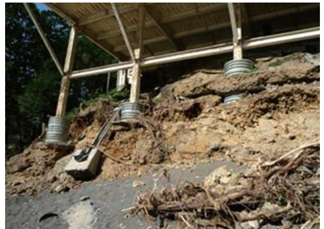
役場駐車場の基礎部の被災
