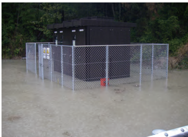
水没した高圧受変電盤
