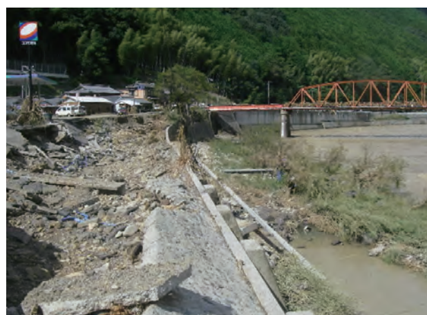
日高川町皆瀬(日高川の護岸損壊、9月5日)
