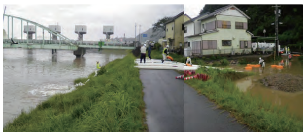
紀宝町鮎田地区で稼働する排水ポンプ車(9月4日)
