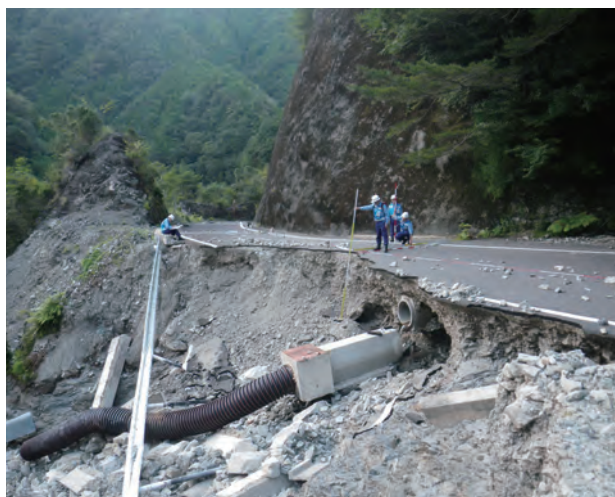
県道古座川熊野線古座川町宮ノ平(9月10日)
