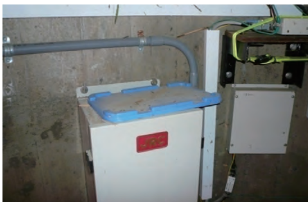
辻堂観測所局舎内
