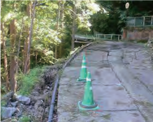
十津川村小井 村道の沈下(9月8日)
