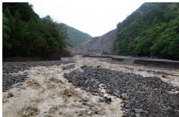
工事用進入路の被災(24年6月22日)
