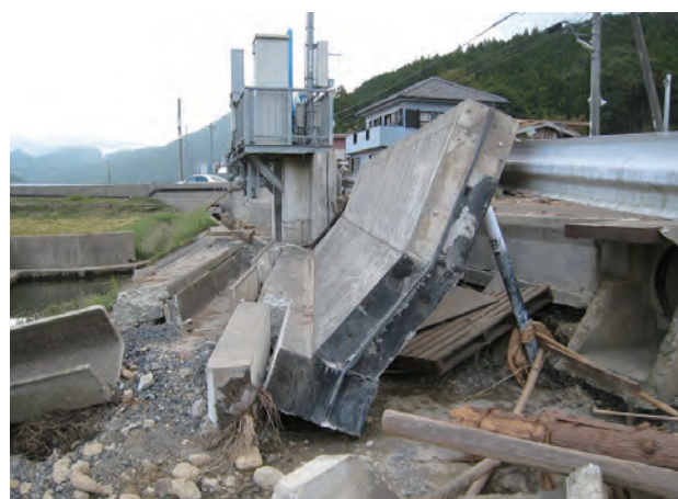
③大里地区の輪中堤取付部(止水壁)の倒壊2(9月6日)
