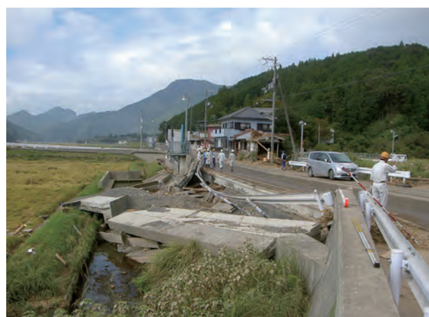
③大里地区の輪中堤取付部(止水壁)の倒壊1(9月6日)
