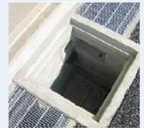
設置している雨水浸透ます
