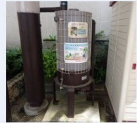
設置している雨水貯留タンク
