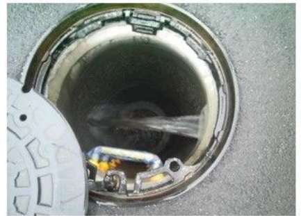
大雨時の吸込状況
