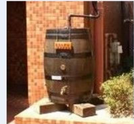
設置している雨水貯留タンク
