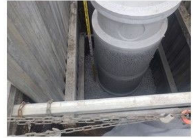
吸込槽の設置状況
