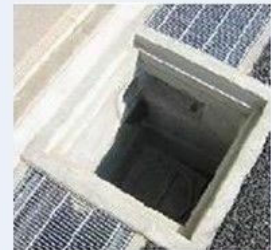
設置している雨水浸透ます
