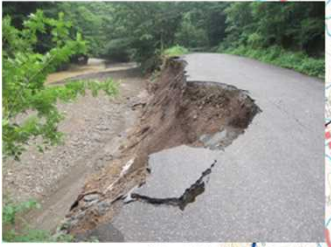
No.75 路肩欠損
