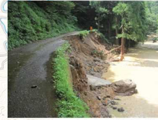
No.54 路肩欠損
