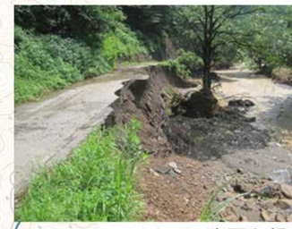
No.49 路肩欠損
