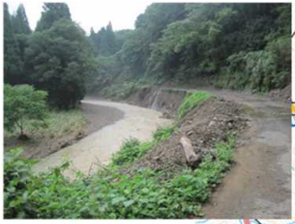
No.81 路肩欠損 五位谷橋 L=21.3 W=8.0
