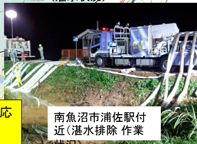
南魚沼市浦佐駅付近 (湛水状況)
