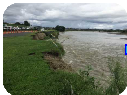
▲護岸の変状箇所
