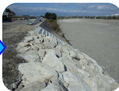
▲変状箇所への対策
