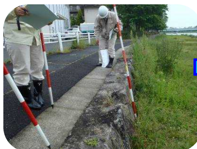
▲護岸の変状箇所
