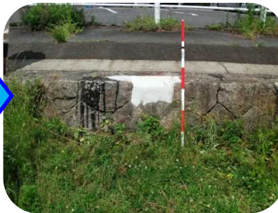
▲変状箇所への対策
