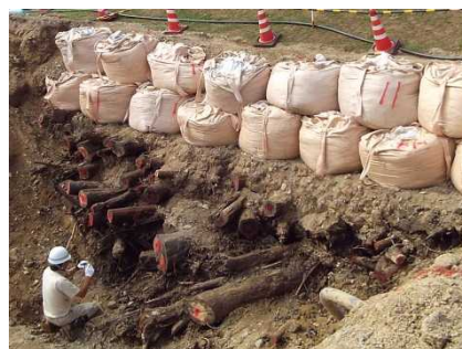
▲ 樹木の埋設状況
