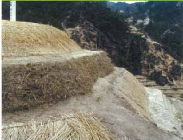
床掘及びわら伏込み完了後、山芝にて仕上げる。本工法は、山腹工の代表的工法である。
