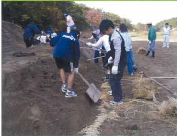
琵琶湖河川事務所が主催する砂防体験学習で施工体験を行う小学生達
