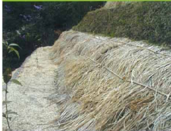
階段工天端に黒松の2年生及びヒメヤシャブシの1年生を植栽する。階段工間の裸地は、わら及び植生盤にて被覆する。
