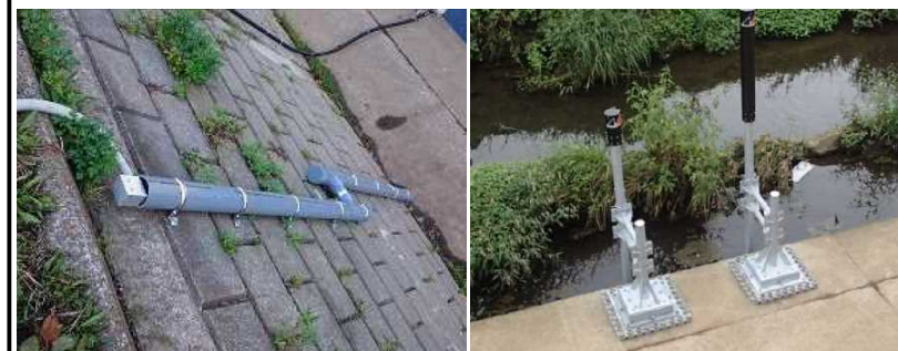
危機管理型水位計の設置事例
