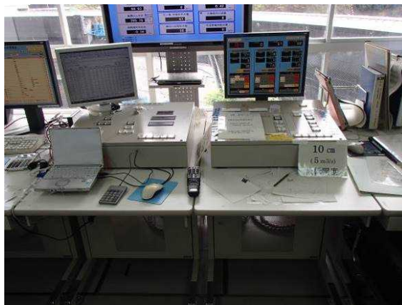
遠方手動操作装置(既設)
