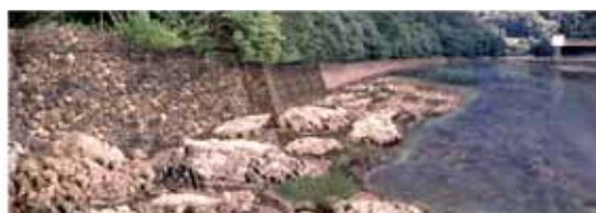
1.1m掘削河道の参考として1.5m掘削時の状況 (流量約 40m 3 /S)
