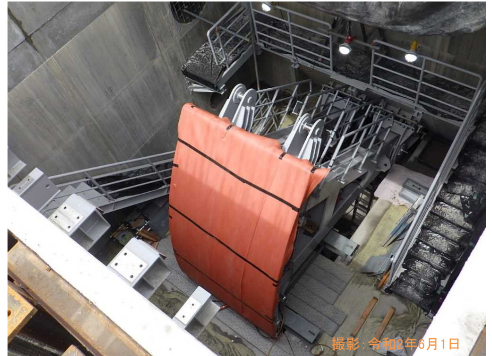
高圧ラジアルゲート
