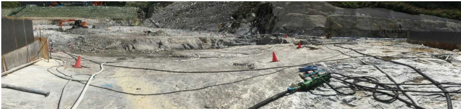
低角度割れ目(掘削後)
