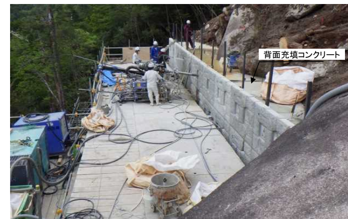
壁面パネルの背後にコンクリートを充填し、アンカーで地山と一体化させる
