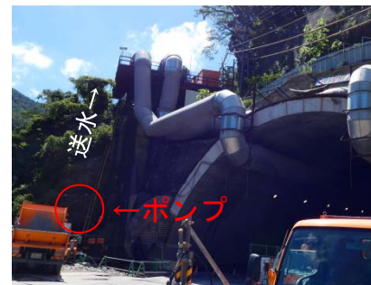
▲送水ポンプ設備
