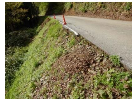
路肩欠損の状況
