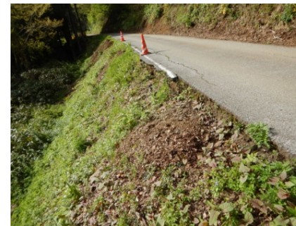
路肩欠損の状況
