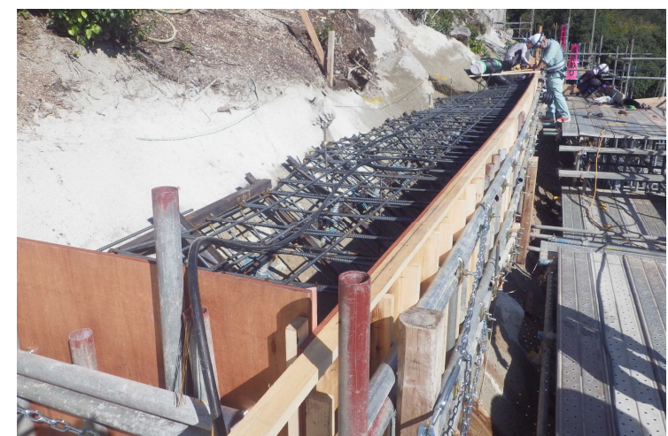
アンカー上部に鉄筋Coを施工し、ルートパイル基礎部分を構築。
