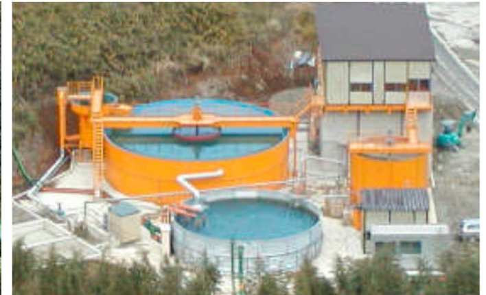
濁水処理施設（他ダム事例）
