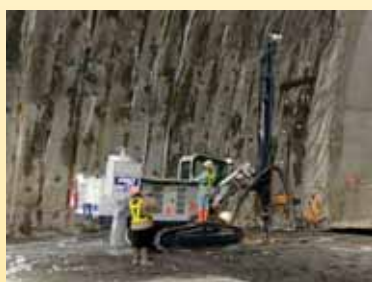
油圧クローラドリルにて爆薬を装填するため穿孔・装薬を行います。
