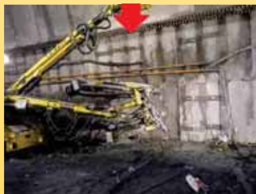
鋼製のボルトを岩盤に打ち込み地山とコンクリートを一体化させます。
