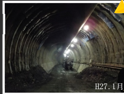
上半掘削が終わった後、下半部の掘削をしました(円形に近づきました)
