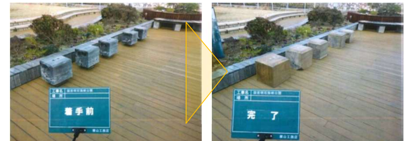
海のテラス (椅子腐食) 椅子撤去→新規設置
